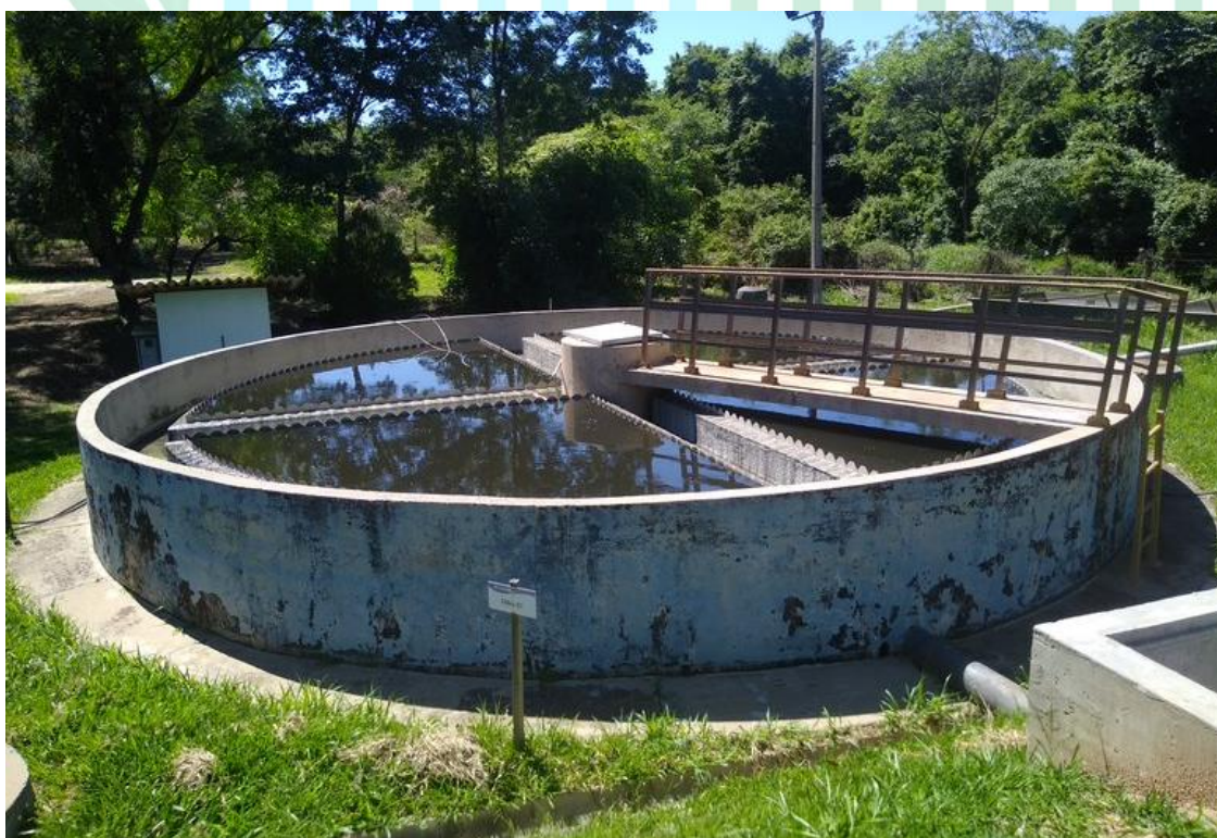
Figura 15 - Estação de tratamento de efluentes SANEPAR de Tomazina.
