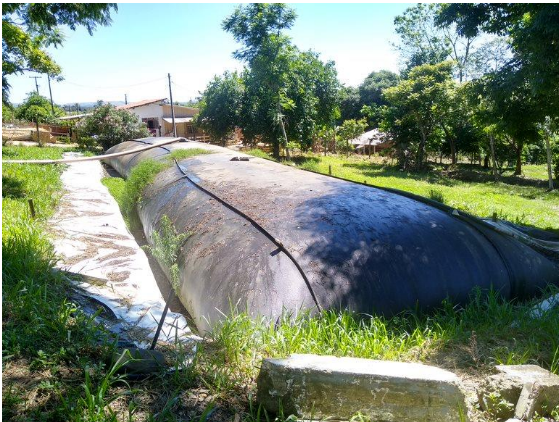
Figura 13- Estação de tratamento de efluentes SANEPAR de Tomazina.
