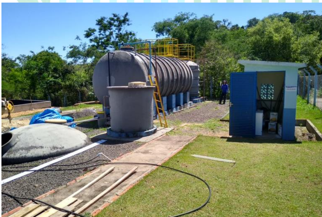
Figura 12 - Estação de tratamento de efluentes SANEPAR de Jaboti.
