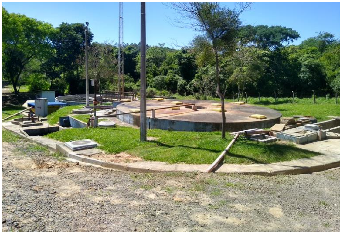
Figura 14 - Estação de tratamento de efluentes SANEPAR de Tomazina.
