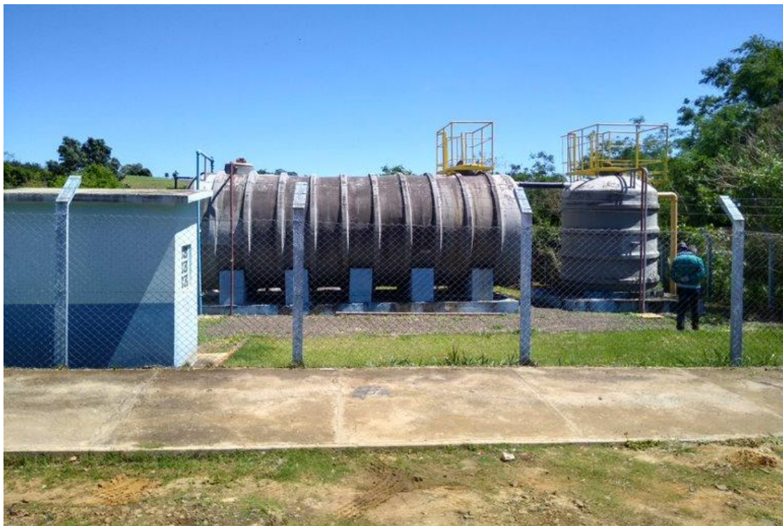
Figura 11 - Estação de tratamento de efluentes SANEPAR de Jaboti.
